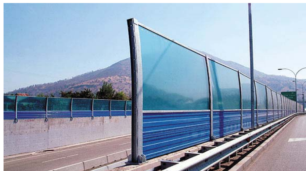
Barreira Acústica de Acrílico- Linha Vermelha, RJ
